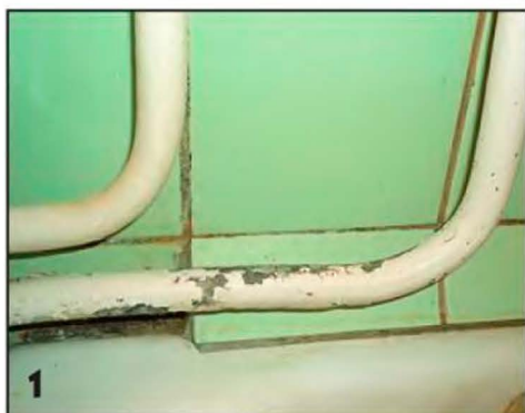
Краска на трубах начала трескаться и отслаиваться — пора заняться ремонтом.
